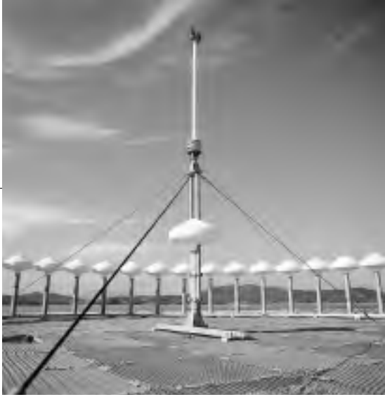
전방향표지시설 및 거리측정장비는 항공기에 방위 및 거리정보를 제공한다
